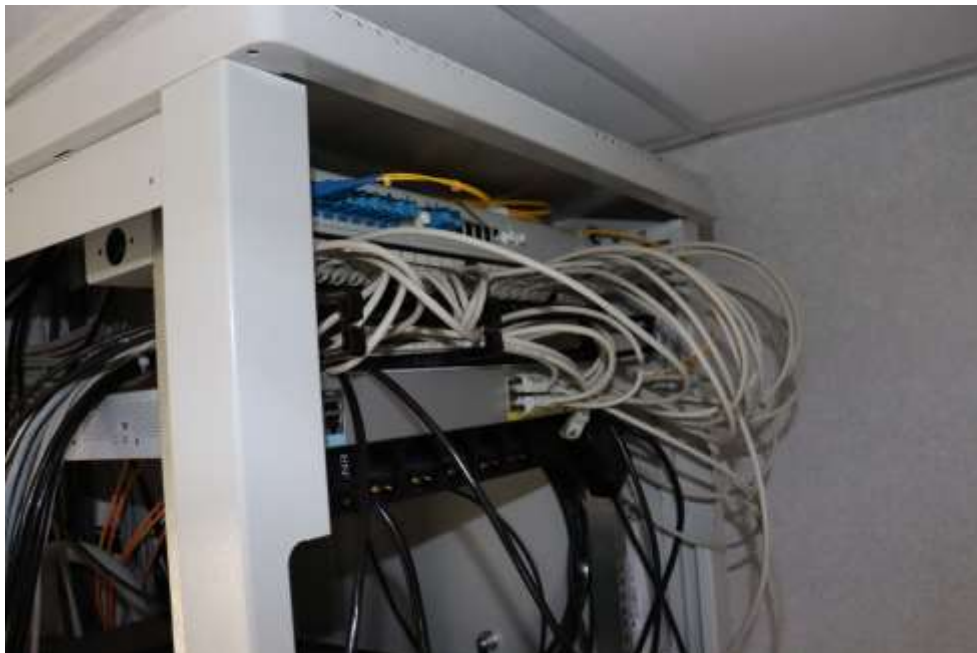
Коммутационные узлы КПП и ПЦН
