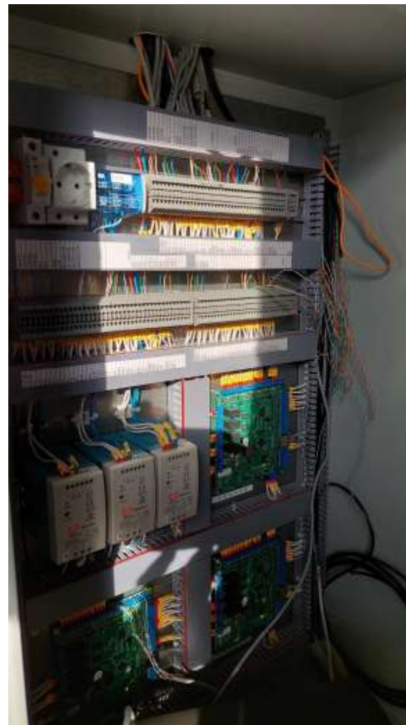
Шкаф СКУД КПП
