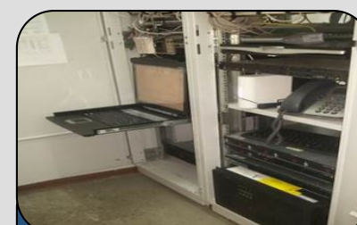
Серверное оборудование диспетчерских
