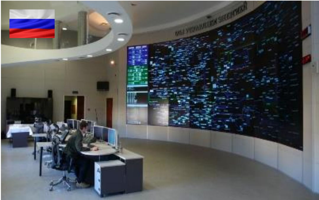
Комплекс диспетчерских залов ОАО «Башкирэнерго» г. Уфа
