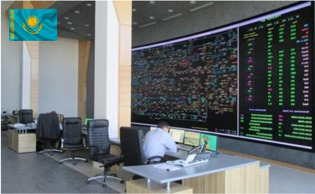
Диспетчерский центр Казахской компания по управлению электрическими сетями АО «KEGOC»
