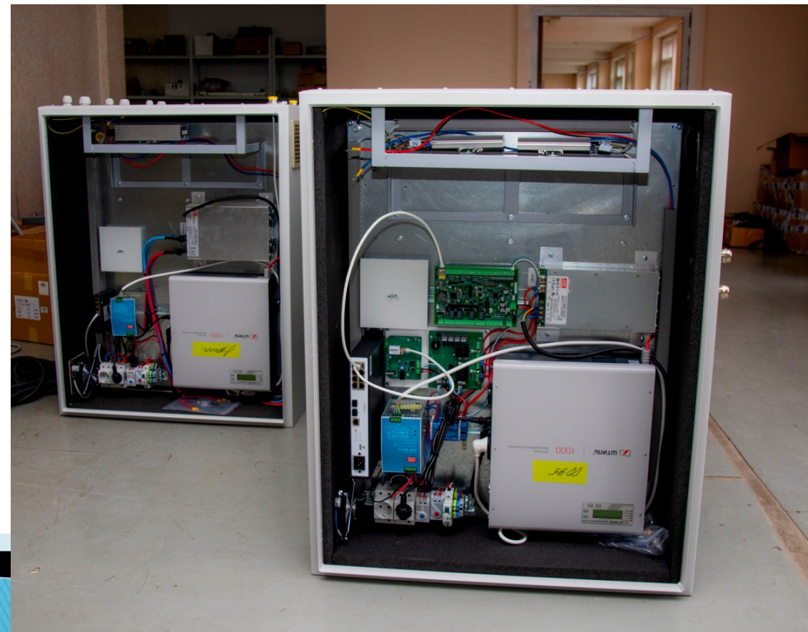
Комплект энергообеспечения комплекса
